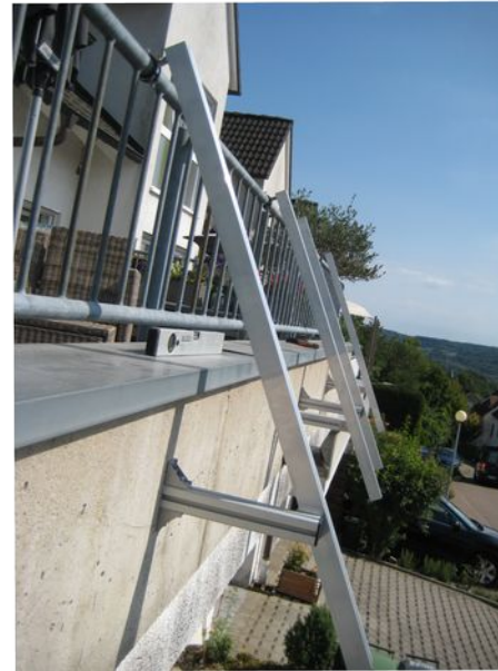
4x Stützen für 2x PV-Module
