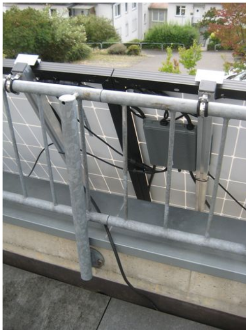
Wechselrichter-Befestigung auf der Außenseite des PV-Profiles
